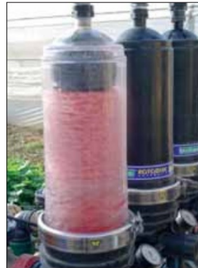
Fig. 2 Fase de contralavado
